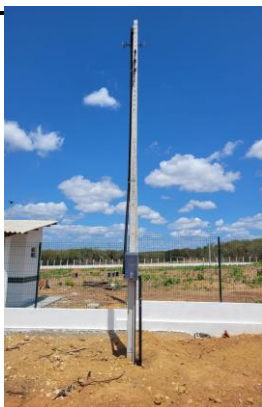
ENTRADA DE ENERGIA
