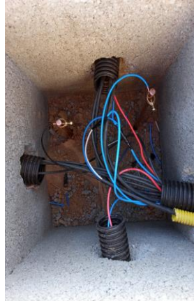
CABO DE COBRE FLEXIVEL ISOLADO, 16 MM 2 , ANTI-CHAMA 450/750 V, PARA CIRCUITOS TERMINAIS - FORNECIMENTO E INSTALAÇÃO. AF_03/2023
