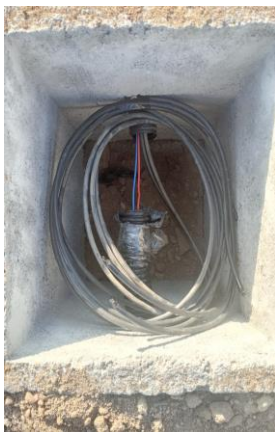
CABO DE COBRE FLEXIVEL ISOLADO, 6 MM 2 , ANTI-CHAMA 450/750 V, PARA CIRCUITOS TERMINAIS - FORNECIMENTO E INSTALAÇÃO. AF_03/2023
