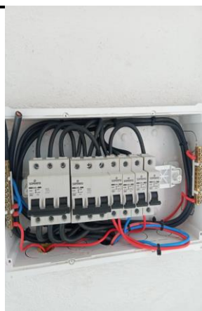
DISJUNTOR MONOPOLAR EM QUADRO DE DISTRIBUIÇÃO 20A
