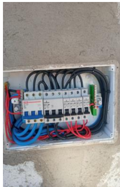
DISJUNTOR MONOPOLAR EM QUADRO DE DISTRIBUIÇÃO 20A
